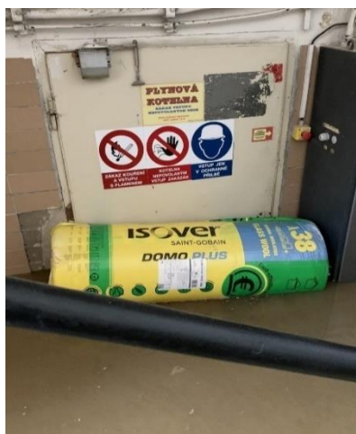
Hlavní budova SŠ-vstup do plynové kotelny
