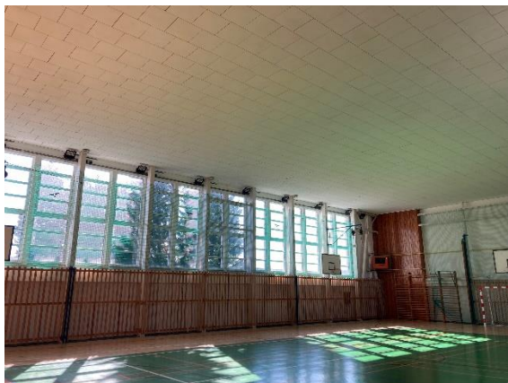
Tělocvična-po výměně osvětlení
